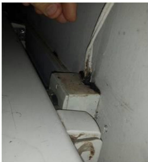
Figura 2- Tomada danificada da cozinha
